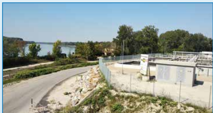
Foto 3: Blick auf die provisorische Baustellenzufahrt vom Betriebsgebäude aus mit Steinwurf als Hochwasserschutz
