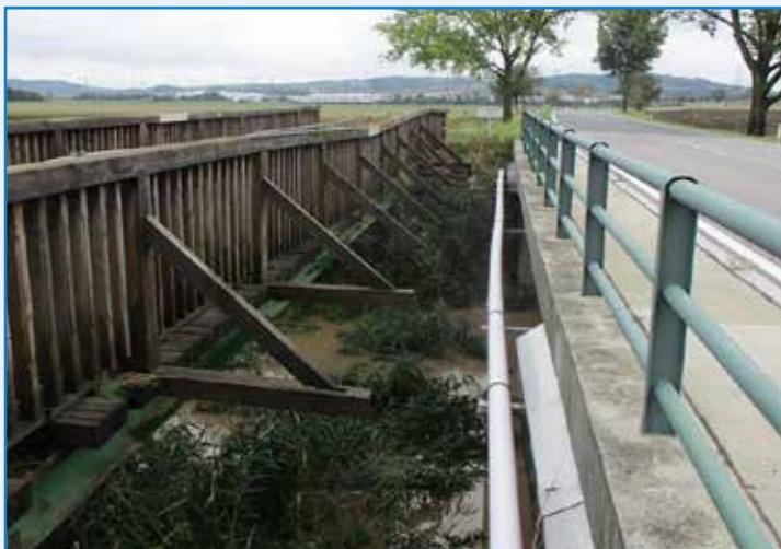
Foto: P. Pawlicki / Sanierungsbedürftige Franz-Blaha-Brücke
